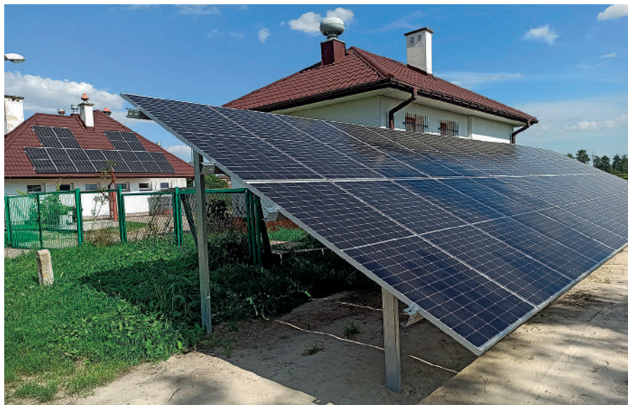
Panele fotowoltaiczne na oczyszczalni ścieków w Pawłowie
